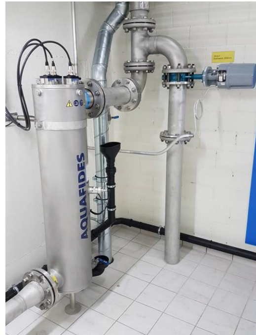
Neue UVC-Anlage Reservoir Weid, Dezember 2018
