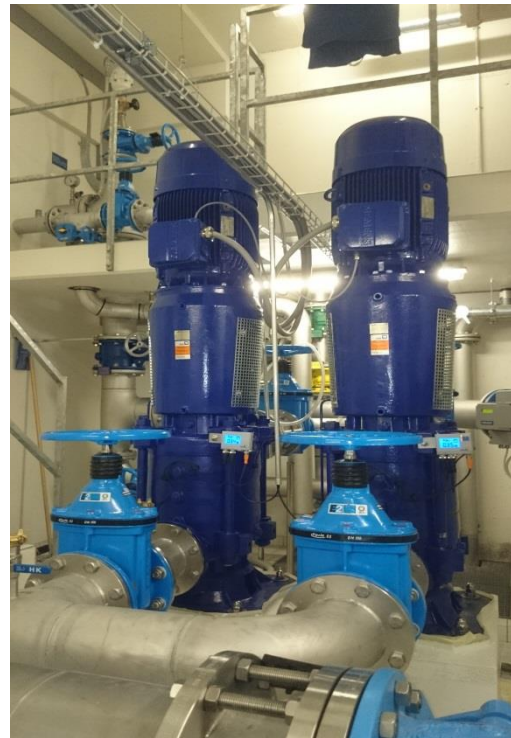
Zwei neue Pumpen im Reservoir Weid
