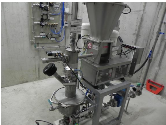
Dosiervorrichtung im neuen Technik-Keller unterhalb des Silos, August 2020
